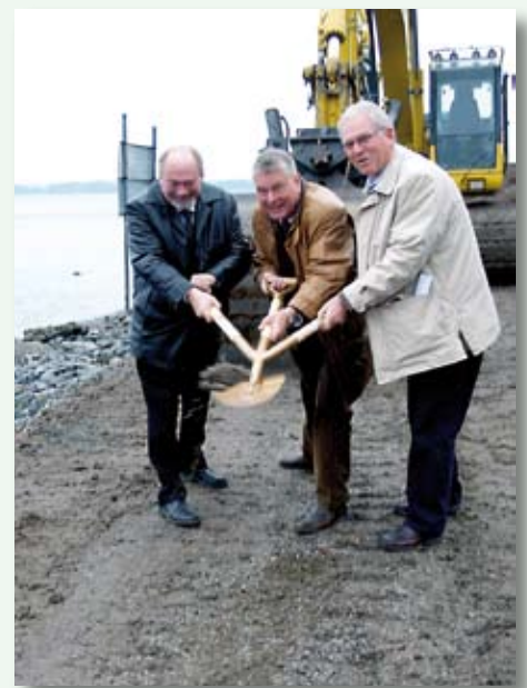
Första spadtaget för ångbåtsbryggan. Från vänster Åke Skoglund, teknisk chef, Peder Holmström (m), ordförande i tekniska utskottet och Christer Karlsson, vd JVAB
